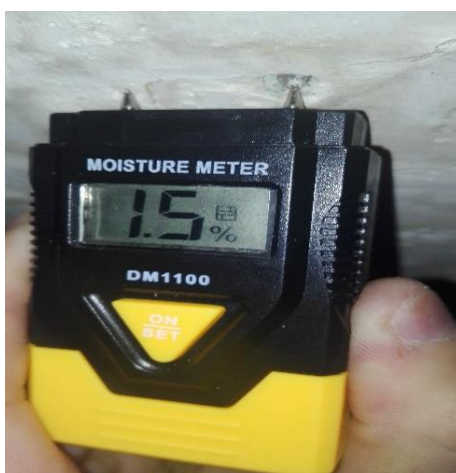
Figura 30. Medición de humedad en la pared después de una semana
