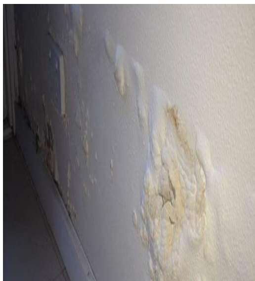
Figura 13. Humedad por Capilaridad
