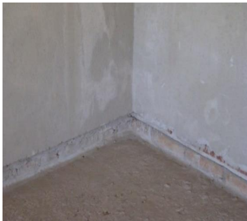
Figura 12. Humedad por Construcción en Obra Tomado de: Seia. M, Arquitectura Simple, (2018)
