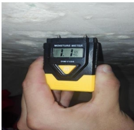
Figura 31. Medición de humedad en la pared después de 2 semanas
