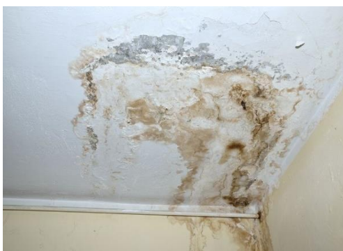
Figura 11. Humedad por la Lluvia producida
