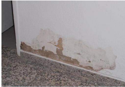
Figura 5. Daño de Humedad en una pared
