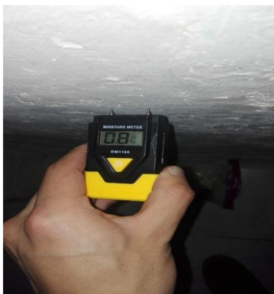
Figura 32. Medición de humedad en la pared después de 3 semanas
