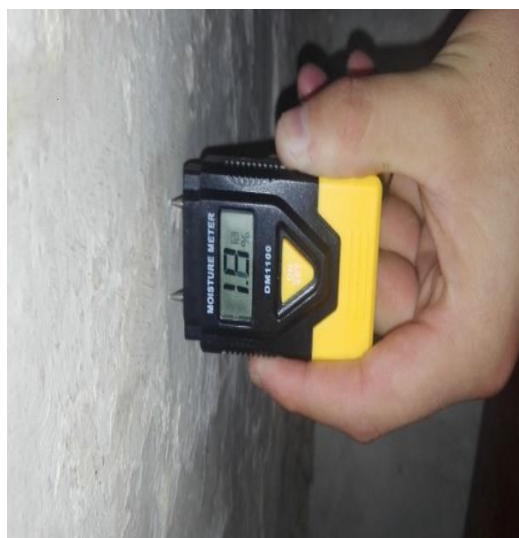
Figura 26. Medición de la humedad en pared afectada
