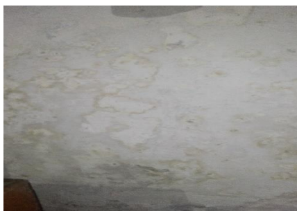
Figura 20. Mampostería Con problemas de Moho
