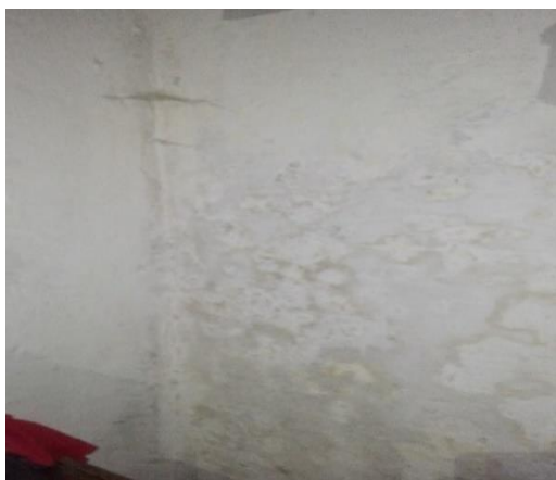
Figura 9. Humedad por Aglomeración
